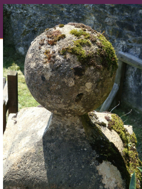
Colonisation de la pierre par les mousses et les lichens Château de Bouillon Belgique
