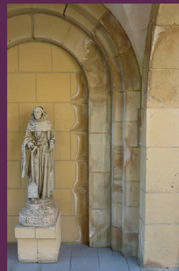
Photo 2 : Zone dégradée par efflorescence de sels et écaillage de la pierre dus à des remontées capillaires d'humidité, Abbaye d'Orval
